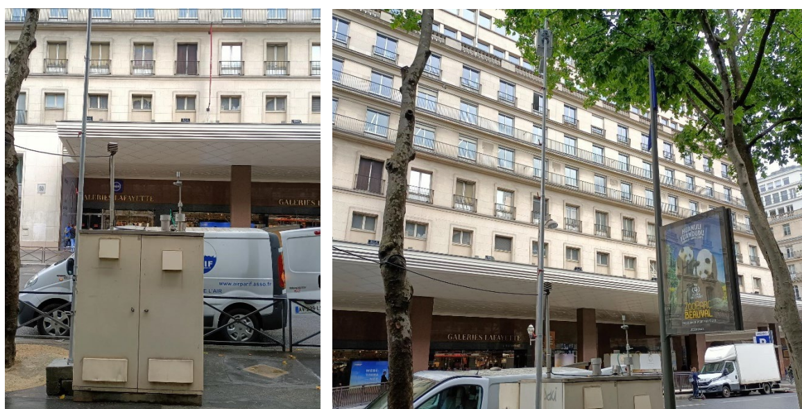
Figure 4 : A gauche, armoire mise en place pour la campagne de mesure des données PUF (se situant à droite de la station HAUS) ; à droite, le dispositif caméra implanté en hauteur au dessus de l'armoire.
